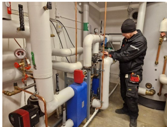
Drifttekniker Tomas Messing inspekterar en värmväxlare som förser fastigheterna med varmvatten och värme.
